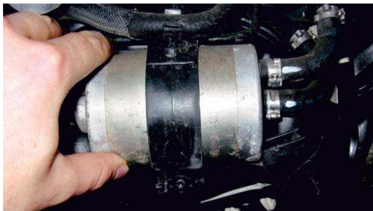
Abb. 6 Kontaktkorrosion aufgrund beschädigter Isolierung
