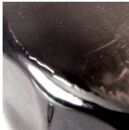
Abb. 1 Riss im Filtergehäuse aufgrund einer Überlastung durch Druckschwankungen
