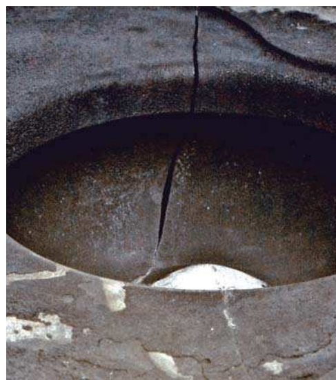
Abb. 1 Risse im Muldenrand
